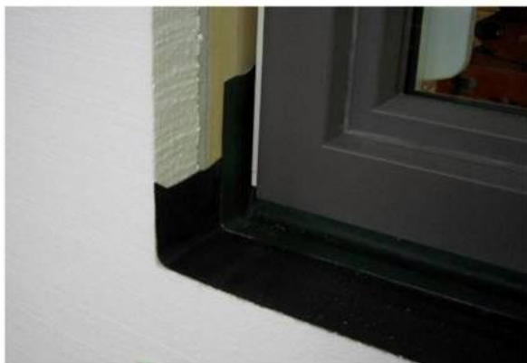
Abbildung 11: Zweite Dichtebene, welche wannenförmig an den Fensterrahmen mittels Folie und Klebeband angeschlossen wird. Seitlich in der Leibung sollte die Folie mind. 6 cm hochgezogen werden
